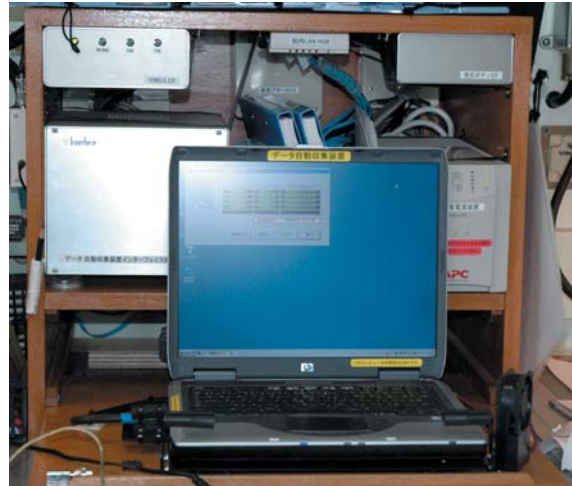
図2．データ収集サーバ(手前のノートPC)とその後方に設置したインターフェイス装置類(海幸丸)
